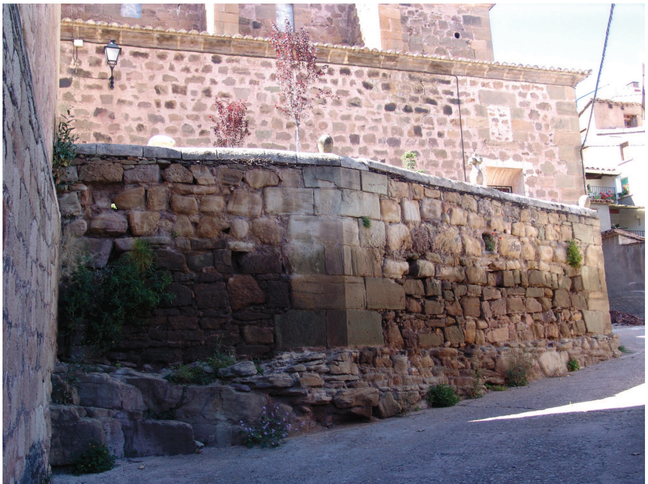
Muro de contención del Cementerio, estructura que requiere un estudio más detallado.
